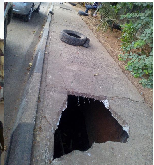
Hueco en acera
